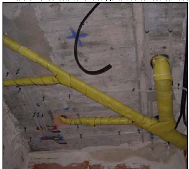
Figura CH-7. Aislamiento de pulpo de desagüe
