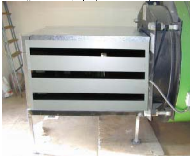
Figura CAL-03. Ejemplo quemador con encapsulado y silenciador para la ventilación del quemador.
