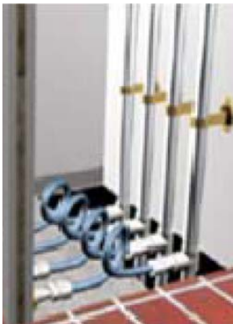
Figura GP-03. Conectores flexibles de conexión con los montantes verticales.
