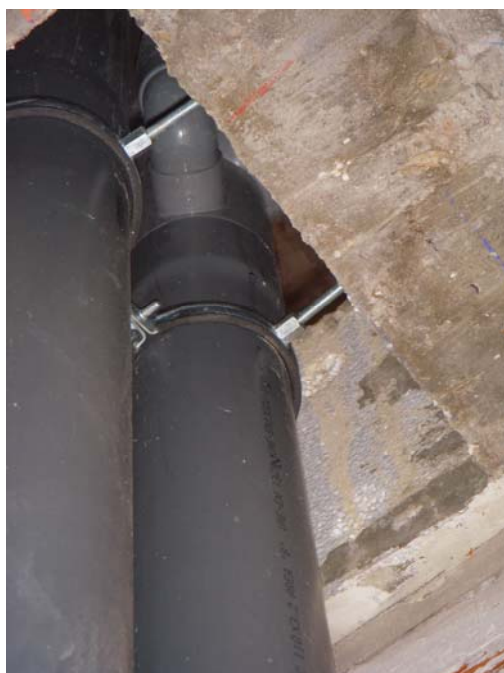
Figura CP-06. Anclaje de bajante a canto de forjado y uso de abrazaderas desolidarizadoras.
