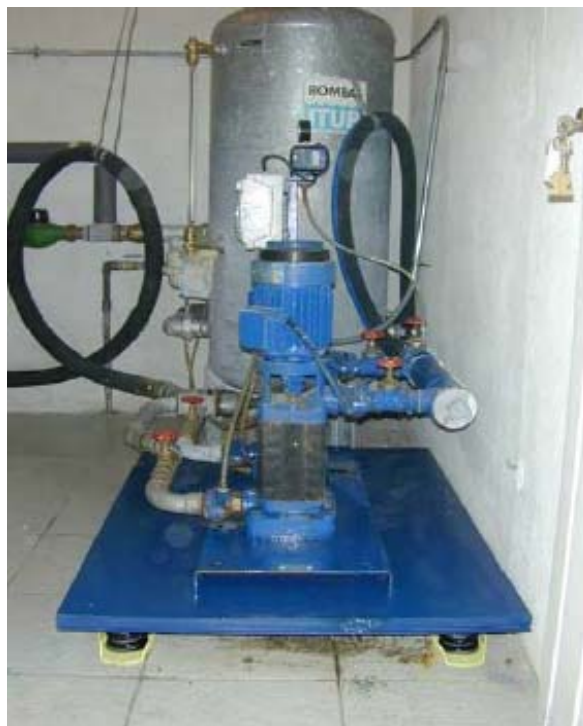
Figura GP-05. Ejemplo bancada de inercia bajo grupo hidroneumático, con amortiguadores bajo bancada y conectores flexibles a la entrada y salida de las tuberías a las bombas.
