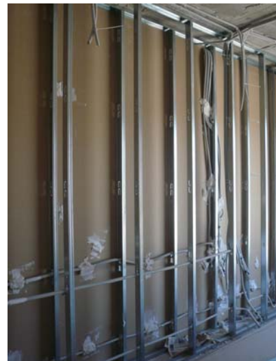
Detalle ESV-03.b.V3. Instalación incorrecta de las instalaciones. Deben evitarse los contactos rígidos entre las hojas de las placas
