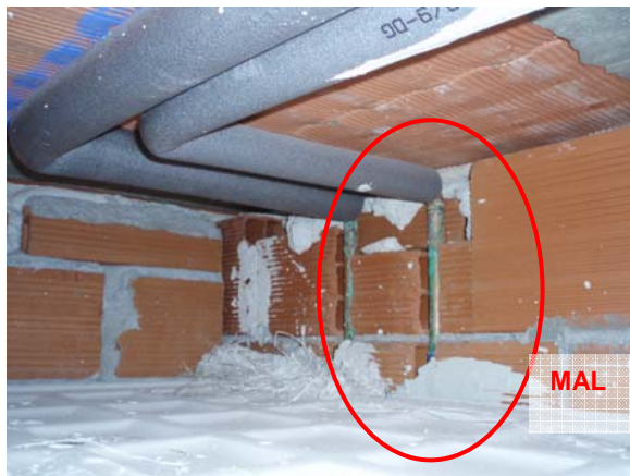
Figura CH-3. Detalle de tuberías empotradas en la partición sin retacar en una partición sin revestir en el espacio que queda por encima del falso techo.
