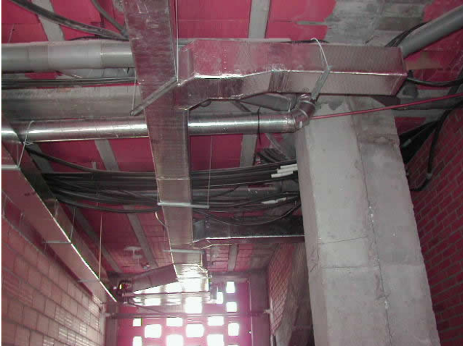
Figura CLI-03. Ejemplo de conductos de climatización
